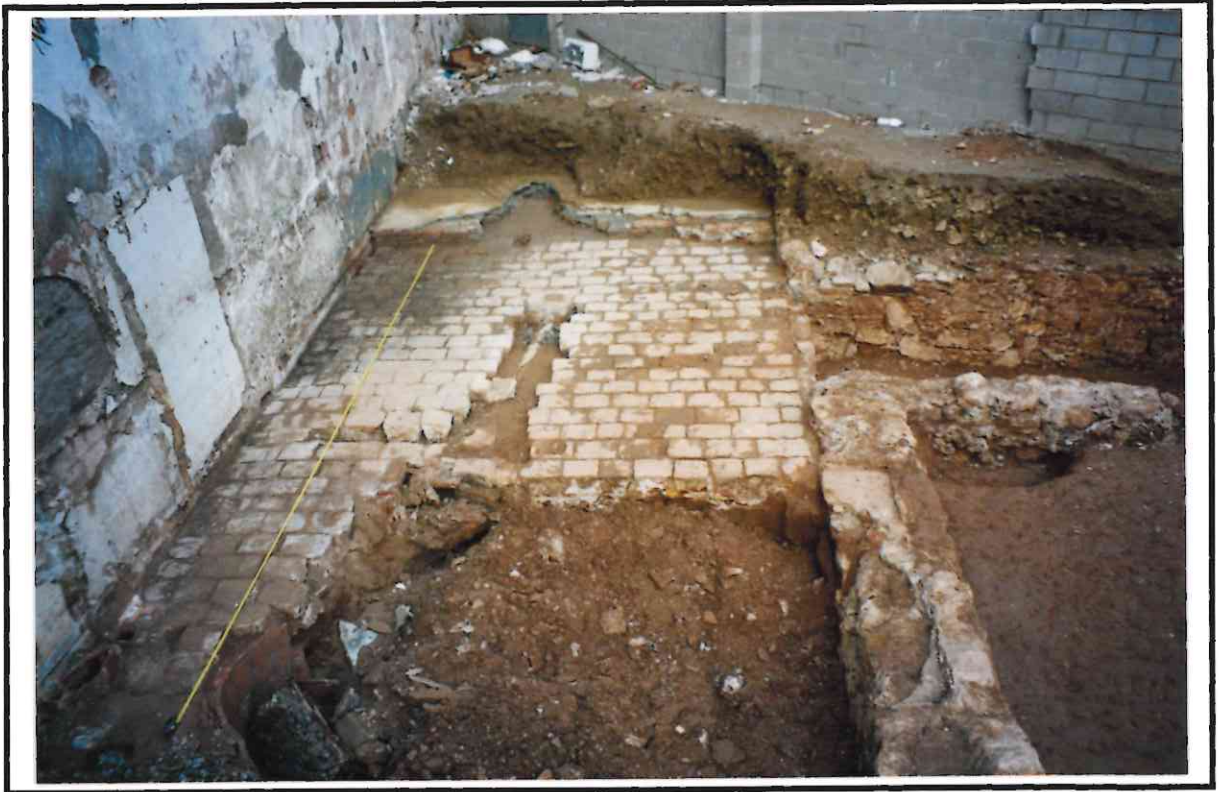
F. 2. Vista general del Sector 1. El mur gris del final correspon al c/Riera Alta.
